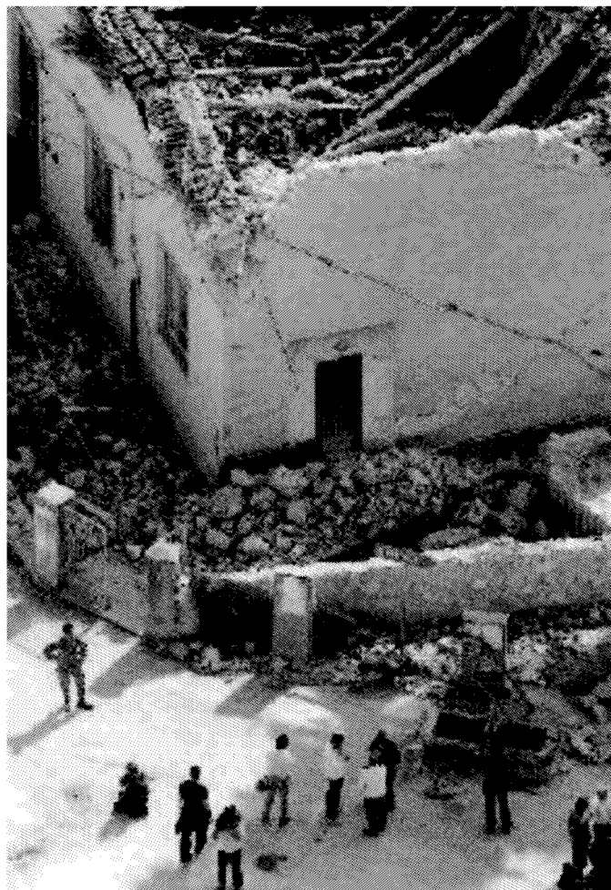
Una casa completamente distrutta
