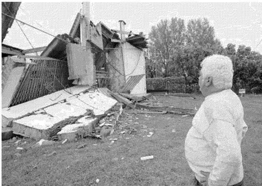
I crolli Un abitante di Mirabello, in provincia di Ferrara, osserva i danni provocati dal terremoto (foto Stefano Cavicchi)
